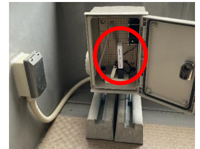
※屋外へ温湿度センサーを1台設置
